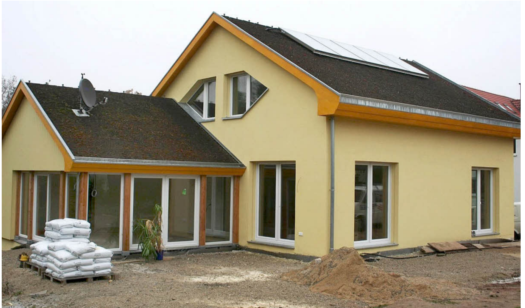
Das von Architekt Michael Trykowski geplante Passivhaus in Hemhofen-Zeckern. Oben rechts Peter Büttner, der die Brauchwasserbereitung installiert.
